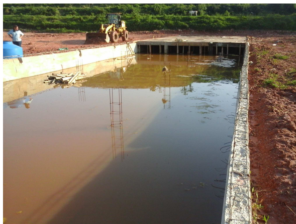
Tanque de coleta de chorume
