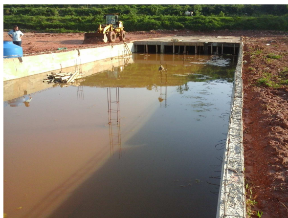
Tanque de coleta de chorume
