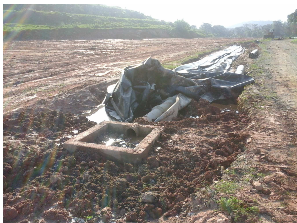
Caixa e tubulação do coletor tronco drenagem de base
